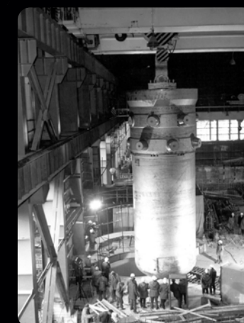
Preprava do šachty revízie
