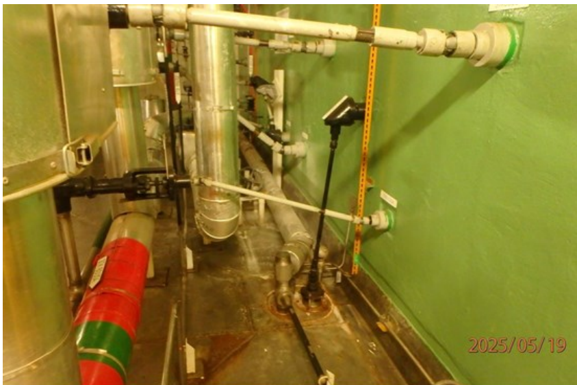
3. RB, kyselina boritá na podlaze, potrubí a armaturách u 3TK60D02.
