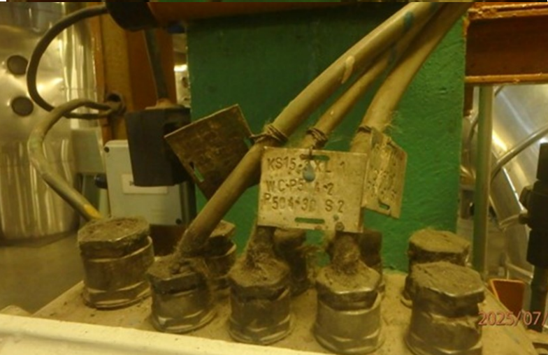
2. RB, podlaží +0,0 m nedostatečná údržba KS 15-3 - průchodky.
